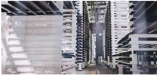
<p>Mehr als ein Lager: Das STOPA-Lager mit 1500 Lagerplätzen der Green Smart Factory sorgt für Unabhängigkeit und Verlässlichkeit in der Fertigung.</p>
